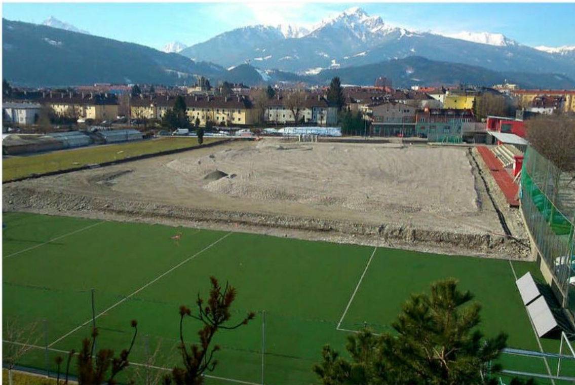
Schotter- statt Fußballplatz: Dieses Baugebrechen ist in dieser Form nicht genehmigt.
