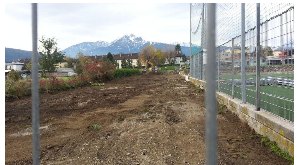
Abriss des asphaltierten Durchgangsweges ohne Errichtung eines Ersatzweges
